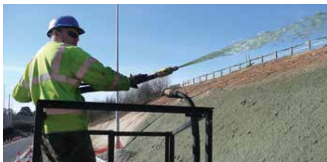
Ứng dụng chống xói mòn HydraMax trên Đường cao tốc M25, Vương quốc Anh.
