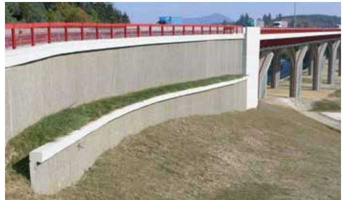
Kết cấu tấm panel và lớp phủ hoàn thiện có thể được áp dụng với các tấm panel dạng đúc sẵn hoặc đổ tại chỗ.
