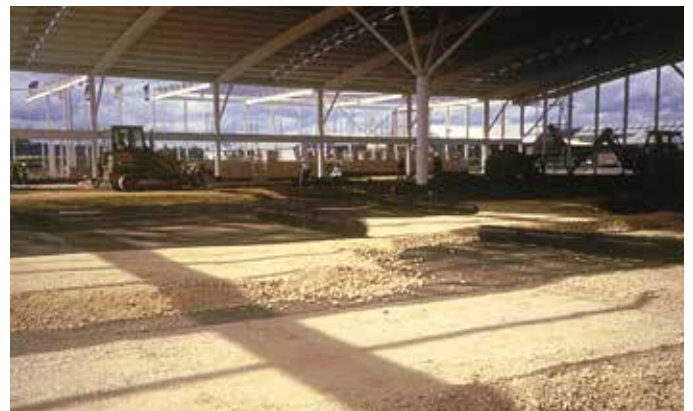
LTP gia cố sàn bê tông với kết cấu bên trên là khung thép nhà xưởng (Anh)
