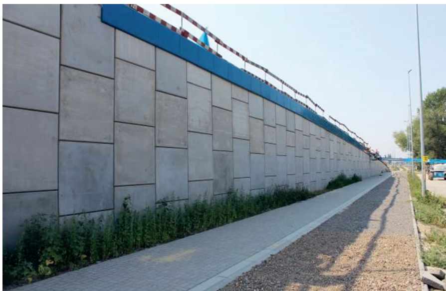
Obr. 4 Výstavba vystuženého oporného múra zo systému TensarTech ARES v centre mesta Lublin, Poľsko
