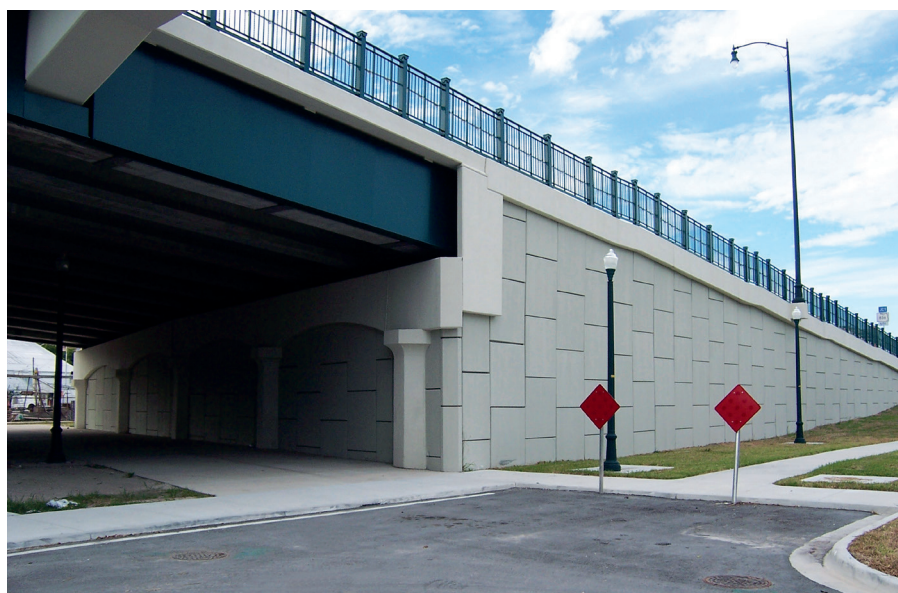
Obr. 2 TensarTech ARES – oporná konštrukcia s minimálnymi nákladmi na údržbu a s návrhovou životnosťou až 120 rokov
